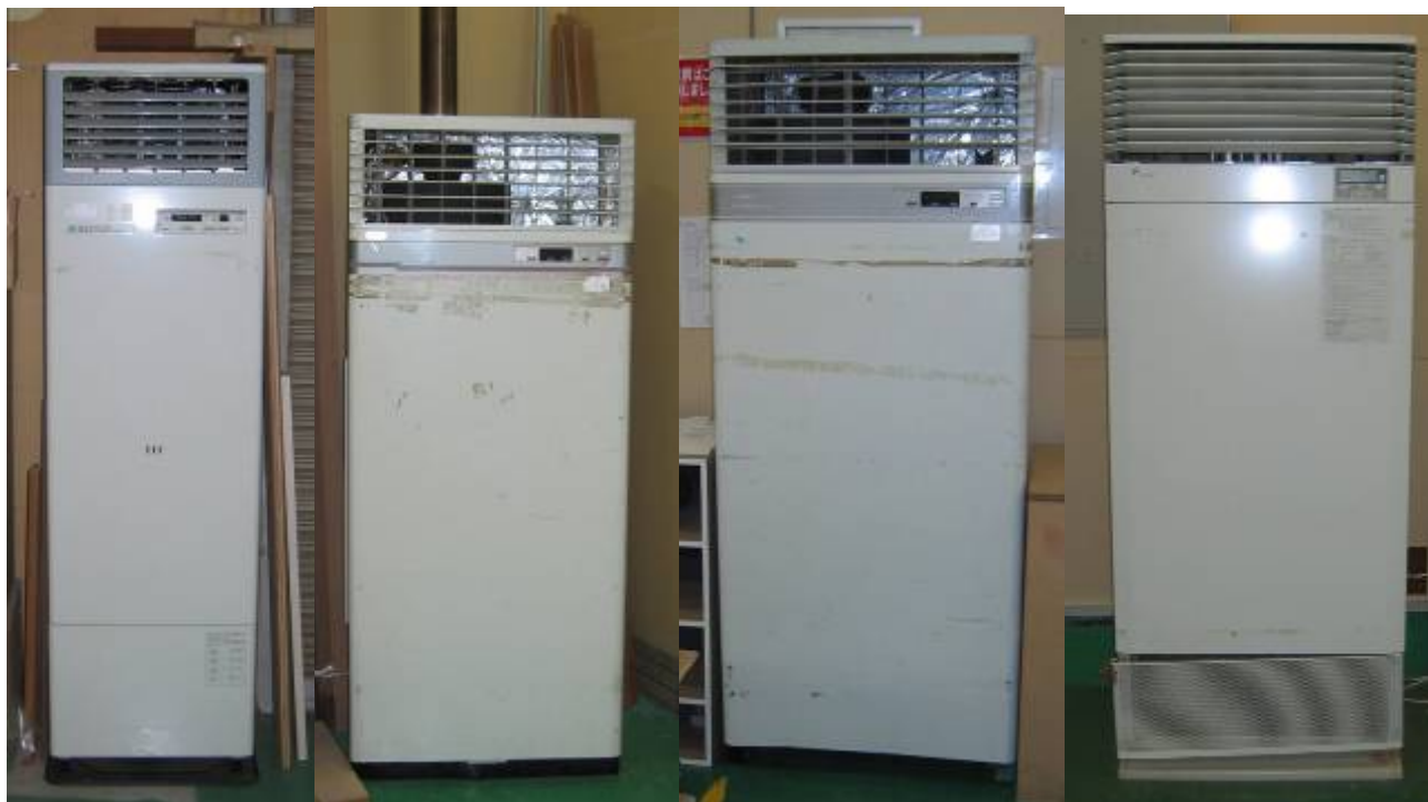
図 事業実施前設備 (石油ストーブ)
